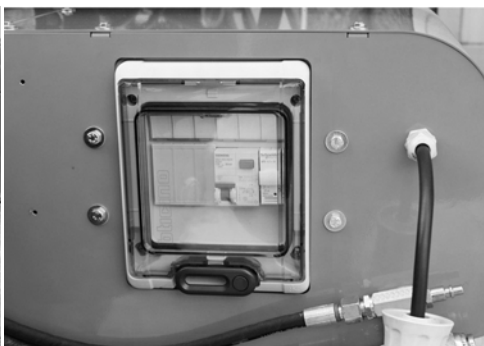
Fig. 88 Automatische magnetothermische schakelaar
