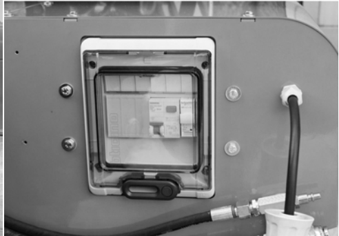
Fig. 161 Automatische magnetothermische schakelaar
