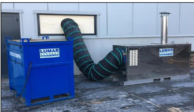
Diesel heater met inblaasslang en brandstoftank
